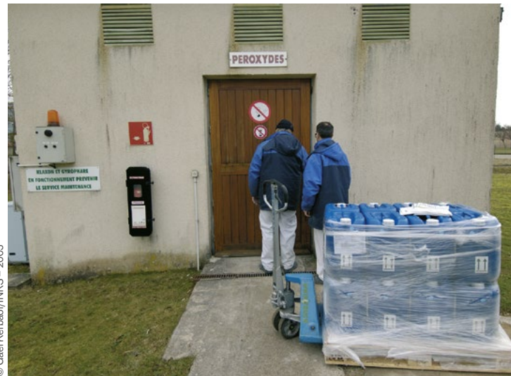
Figure 6. Exemple de bâtiment de stockage dédié aux peroxydes
