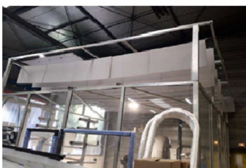
Après : partie supérieure de cette zone fermée par des baffles suspendus
