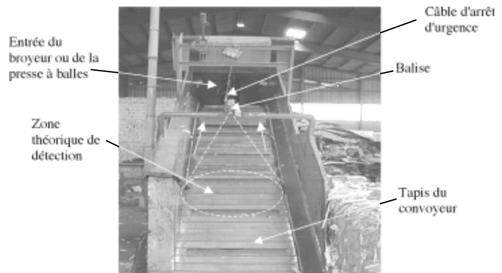
Fig. 5. Mise en œuvre typique d'un dispositif de détection par onde radio sur un convoyeur.
