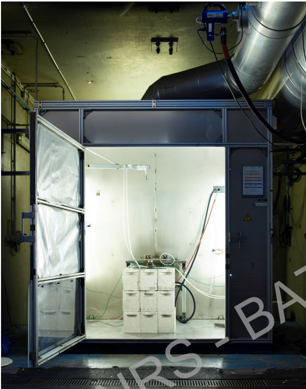
Cellule d'essai électrique
