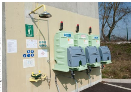
Douche de sécurité et lave-œil en extérieur
