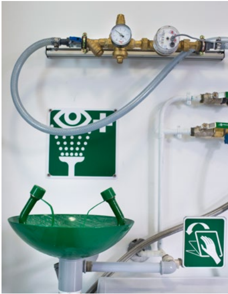
Lave-œil raccordé au réseau d'eau
