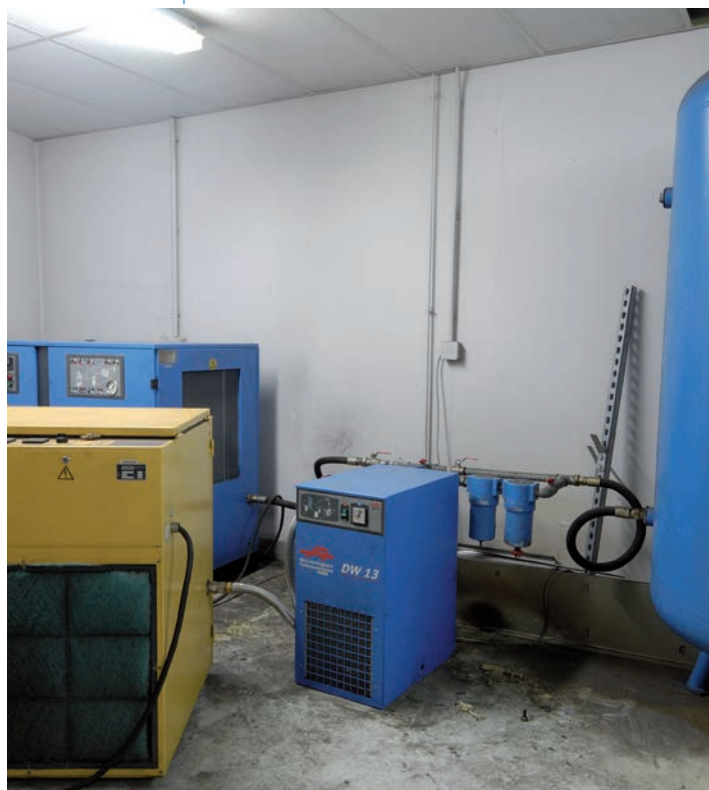
Compresseur d'air dans un local isolé des ateliers et insonorisé
