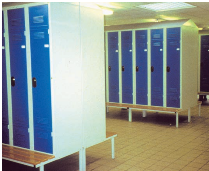
Les armoires-vestiaires sont ventilées. À leur partie basse, des tablettes permettent au personnel de se déshabiller plus aisément. La forme pyramidale de la partie supérieure des armoires empêche de stocker les objets divers qui traînent souvent dans les vestiaires (cela évite la chute d'objets) et permet en outre de nettoyer plus facilement, afin d'éviter une accumulation de poussières.
