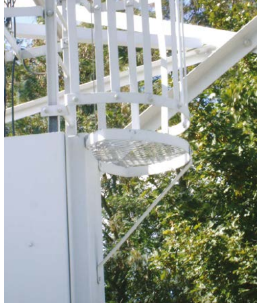
Photo 14 b. Dispositif de condamnation d'accès
