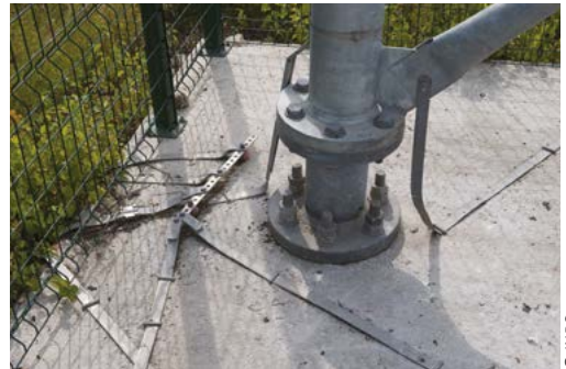
Photo 20. Dispositif de mise à la terre
