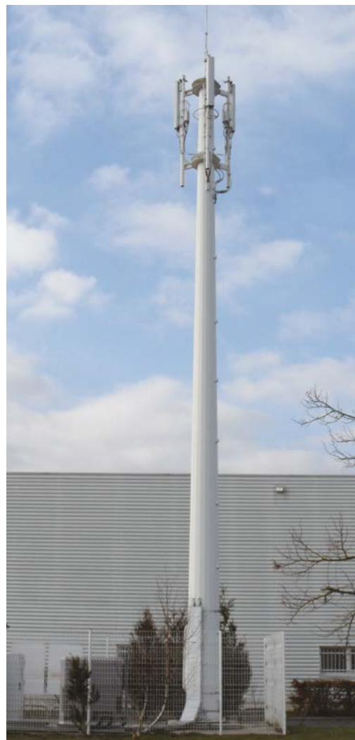
Photo 11. Exemple de pylône monotube
