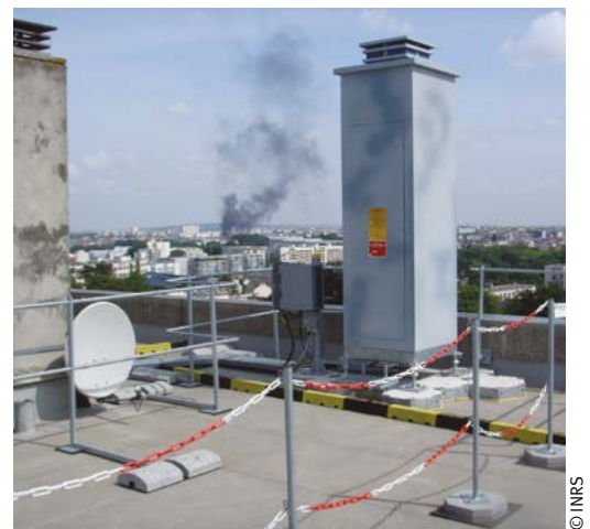
Photo 1. Antennes installées en terrasse d'immeuble et masquées par une cheminée factice
