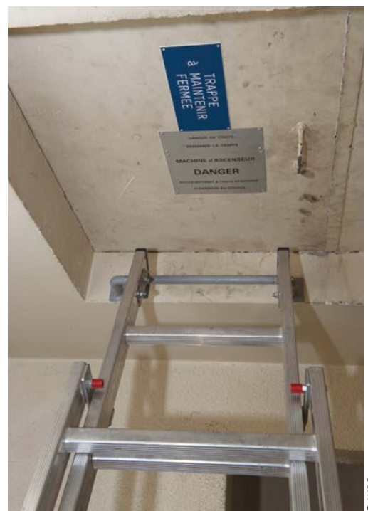
Photo 7. Dispositif de fixation en tête d'échelle au niveau terrasse
