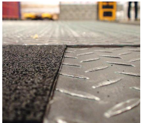
↓ FIGURE 4 Traitement du bourrelet formé par le cordon de soudure sur le plateau du niveleur : matériau amortissant de 2 mm d'épaisseur.
