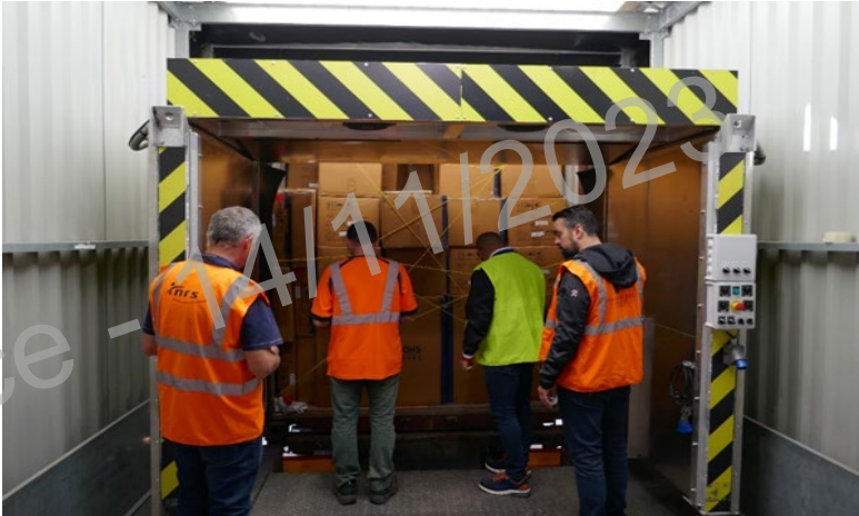
Portique (soufflage, extraction 3000 m 3 /h)
