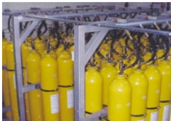
Fig. 1. Exemple de stockage d'IG 100 (azote) - Example of storage of IG 100 (nitrogen)
