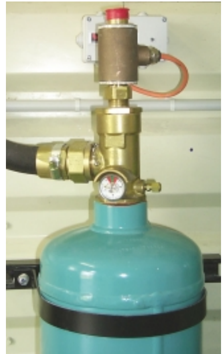
Fig. 4. Exemple de stockage d'HFC 227ea - Example of storage of HFC 227ea
