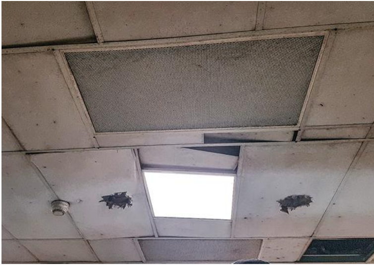
↑ PHOTO 1 Plafond de la cabine de tri : défaut d'ajustements et dégradations des plaques de faux-plafond.
