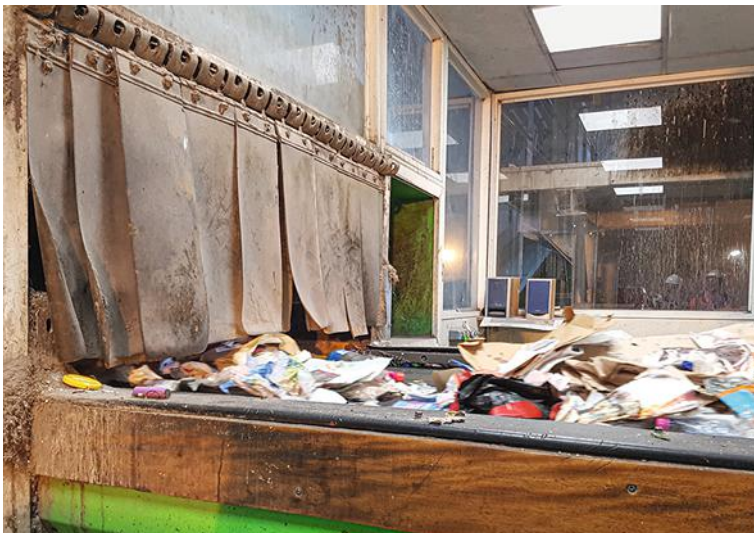
↑ PHOTO 2 Dépôts importants de poussières à l'intérieur de la cabine de tri. Lanières dégradées au niveau de l'entrée des déchets.
