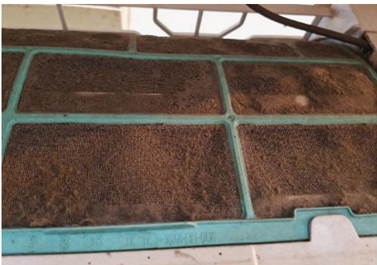
↑ PHOTO 3 Encrassement du filtre du système de traitement de l'air dans la cabine, lié à un défaut d'entretien.
