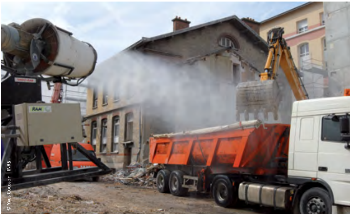
Chargement de déchets avec brumisation
