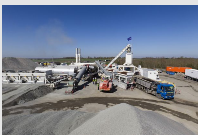
© Philippe Castano pour l'INRS Centrale de fabrication d'enrobé
