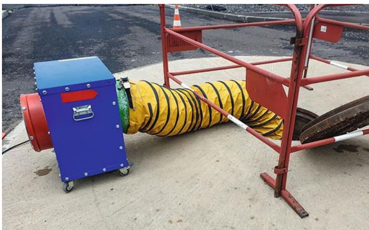
↑ PHOTO 4 Exemple de passage d'une gaine dans un tampon. Le ventilateur (bloc bleu) reste à l'extérieur de l'ouvrage, prélève l'air extérieur (partie en rouge) et l'insuffle dans l'ouvrage via la gaine (jaune). À noter le tampon métallique en position ouvert, permettant le passage de la gaine dans le regard, et la mise en place d'une protection collective contre les chutes, sous la forme d'une barrière rigide.
