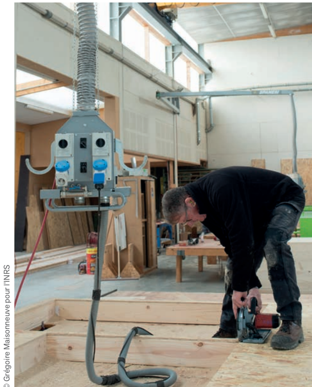
■ Scie circulaire portable reliée à un réseau d'aspiration à haute dépression
