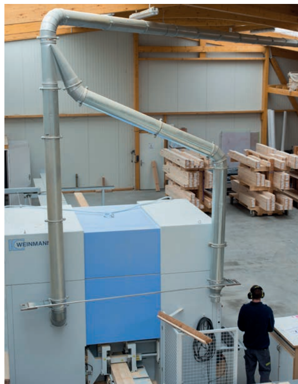
■ Centre d'usinage relié à un réseau d'aspiration
