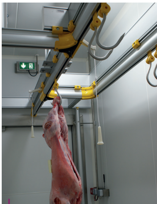
Réseau de rails dans le sas de livraison d'une boucherie.
