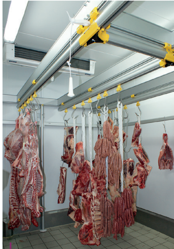
Réseau de rails améliorant le stockage et la manutention des quartiers dans la chambre froide.
