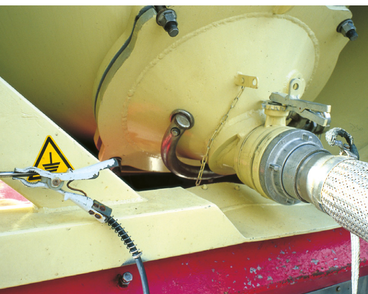
Patte de mise à la terre d'une citerne routière
