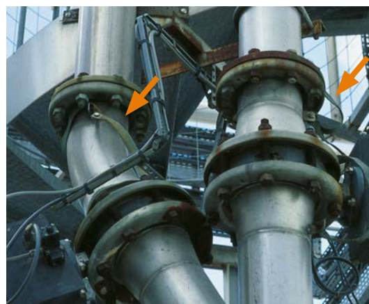
Shunts électriques assurant la continuité électrostatique d'une canalisation dans laquelle circule un solvant
